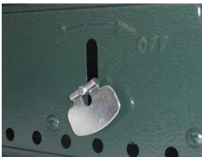
Figure 8 Commande du brûleur auxiliaire
